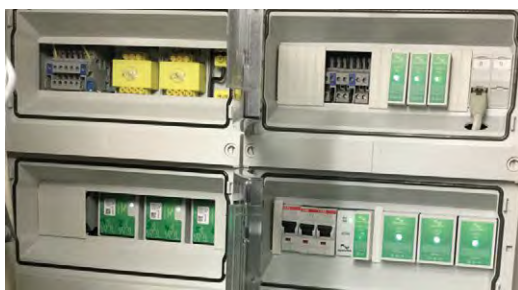
Links digitalSTROM-Module, rechts Sicherung, Filter und Meter
